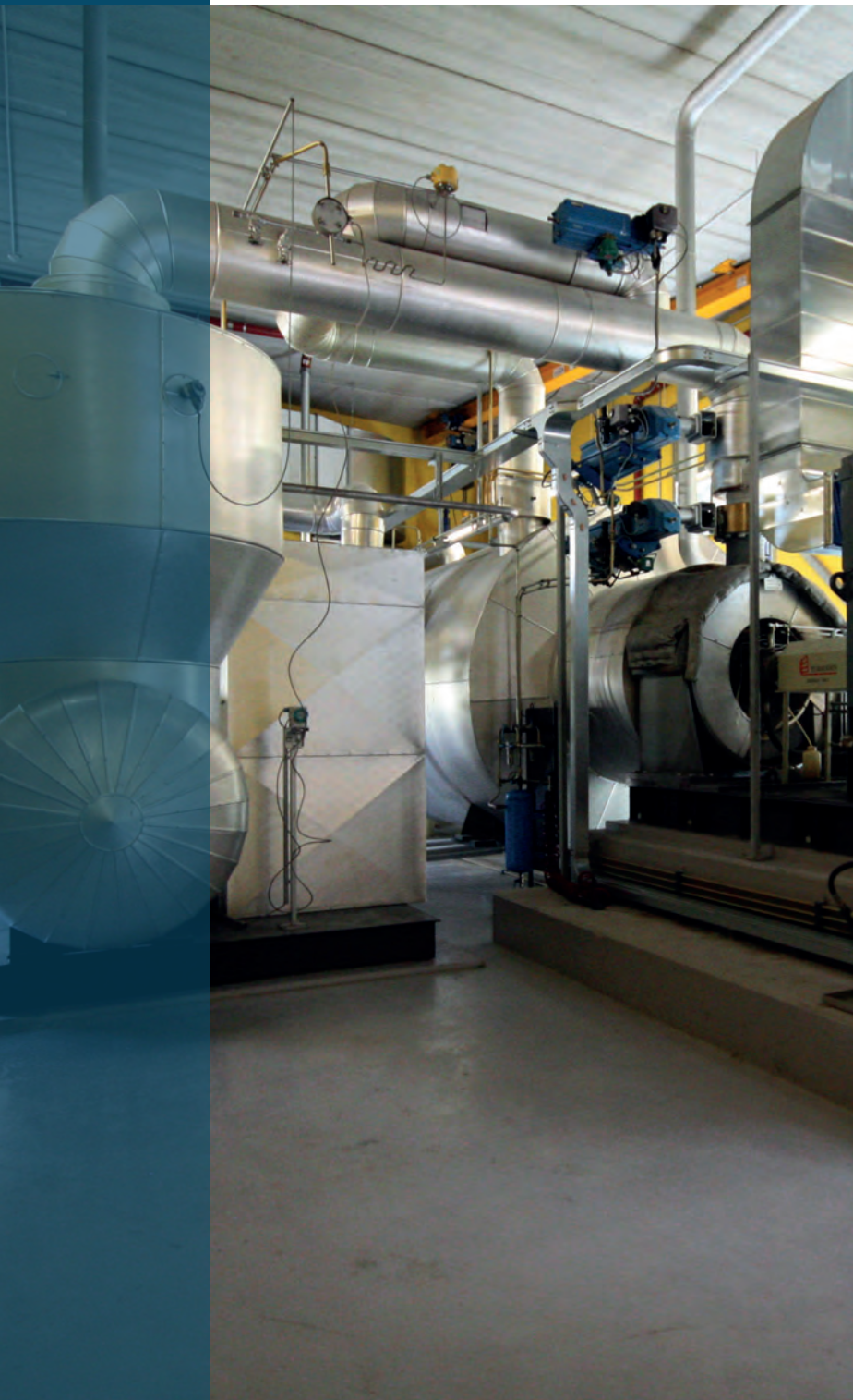
Modulo ORC della centrale di teleriscaldamento di Dobbiaco-San Candido (BZ)
