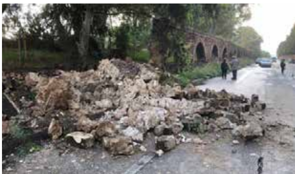
6 Novembre 2018 Il maltempo provoca il crollo parziale dell'acquedotto del Triglio in Puglia
