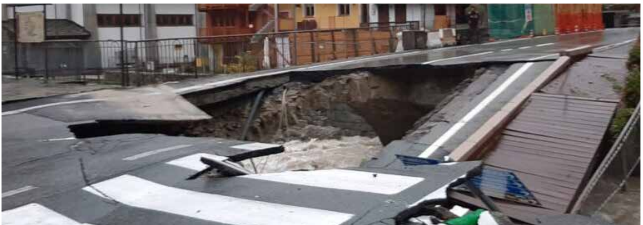
4 Ottobre 2020 Crollo del ponte a Gaby (AO) a causa della violenta alluvione
