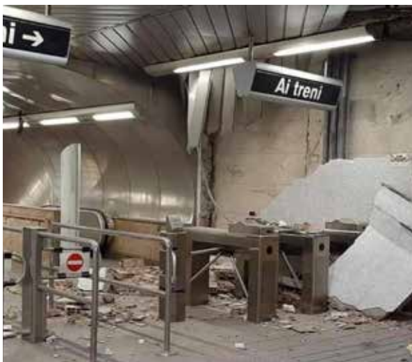
26 Settembre 2020 Crollo nella stazione metro Salvator Rosa a Napoli a causa delle infiltrazioni d'acqua
